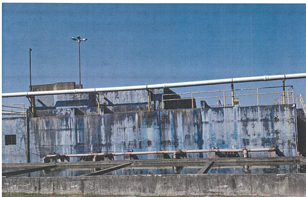
Foto 10 – Junta de concretagem com infiltração na parede – Módulo III
