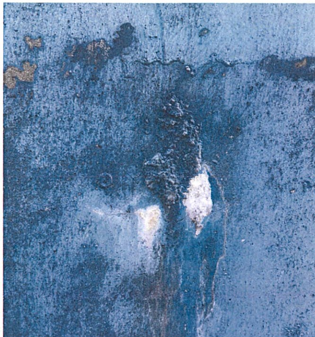
Foto 09 – Furo de travamento de forma preenchido, com infiltração na parede – Módulo III
