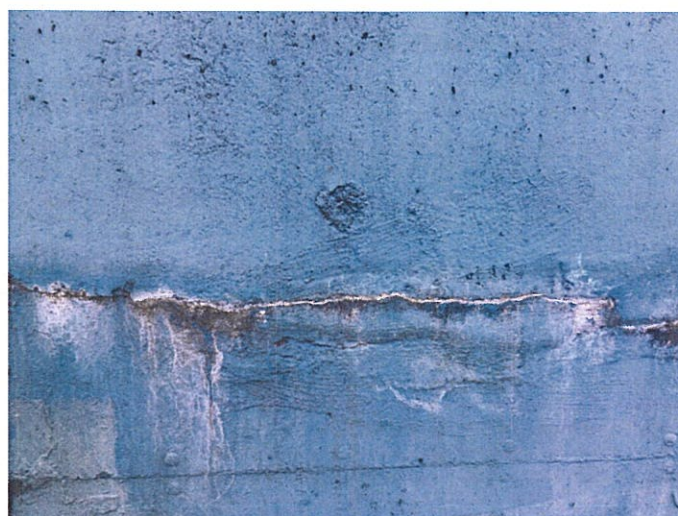
Foto 08 – Fissura horizontal com infiltração na parede – Módulo III
